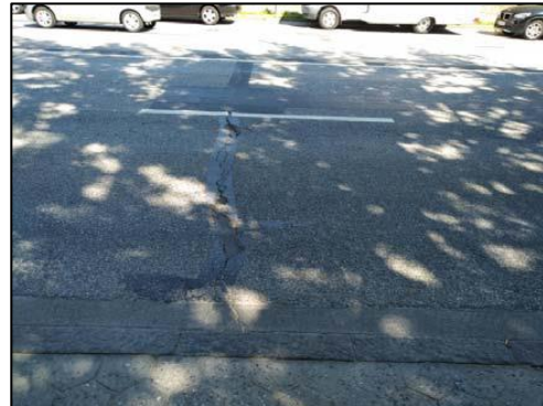
Abbildung 9: schlechter Fahrbahnzustand Steilshooper Straße (Wandsbek) (Quelle: IVAS)
