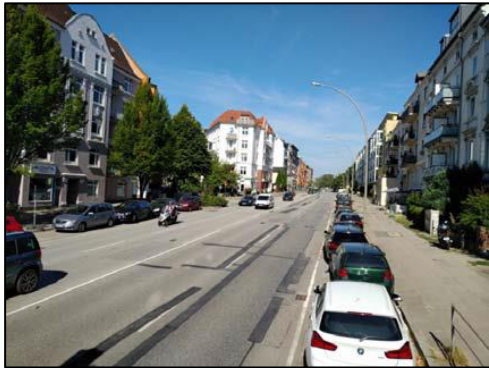
Abbildung 8: schlechter Fahrbahnzustand Lokstedter Weg (Nord) (Quelle: IVAS)
